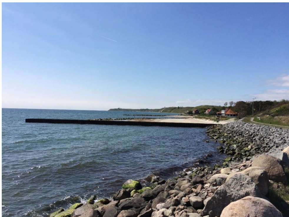
Figur 2. Exempel på erosionsåtgärder vid strandnära bebyggelse med tydlig påverkan på kringliggande miljö. Löderups strandbad, Ystad kommun (Foto P. Danielsson, SGI)
