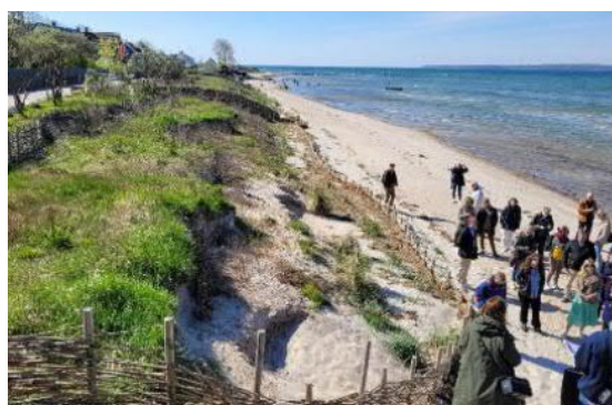
Erosionsskyddet som byggt inom projektet Life Coast Adapt med återfylld sand, växlighet och strandstaket.
